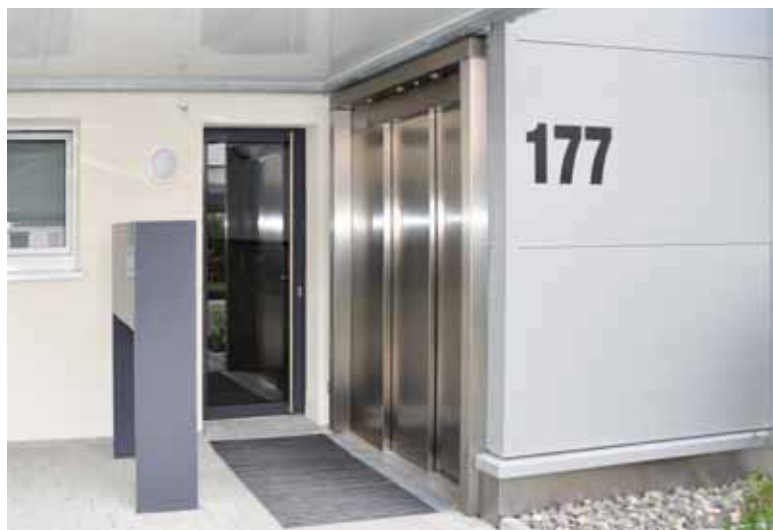
26 Barrierefreie Eingangssituation mit Klingel-/Briefkastenanlage und Aufzug (Mehrfamilienhaus)
