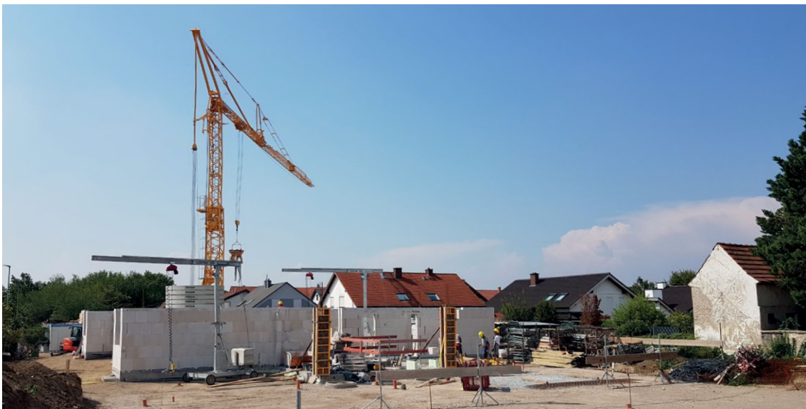
Noch ist es eine Baustelle - aber schon jetzt herrscht großes Interesse an den 24 Wohneinheiten, die hier entstehen
