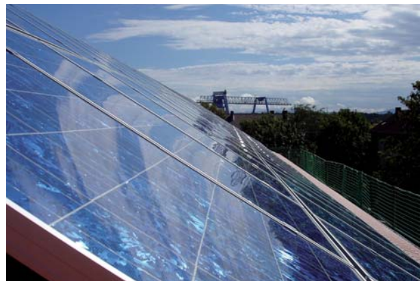
Fotovoltaikanlage Hoheloostraße 1 – 3, Ludwigshafen (Quelle: GAG Ludwigshafen am Rhein)
